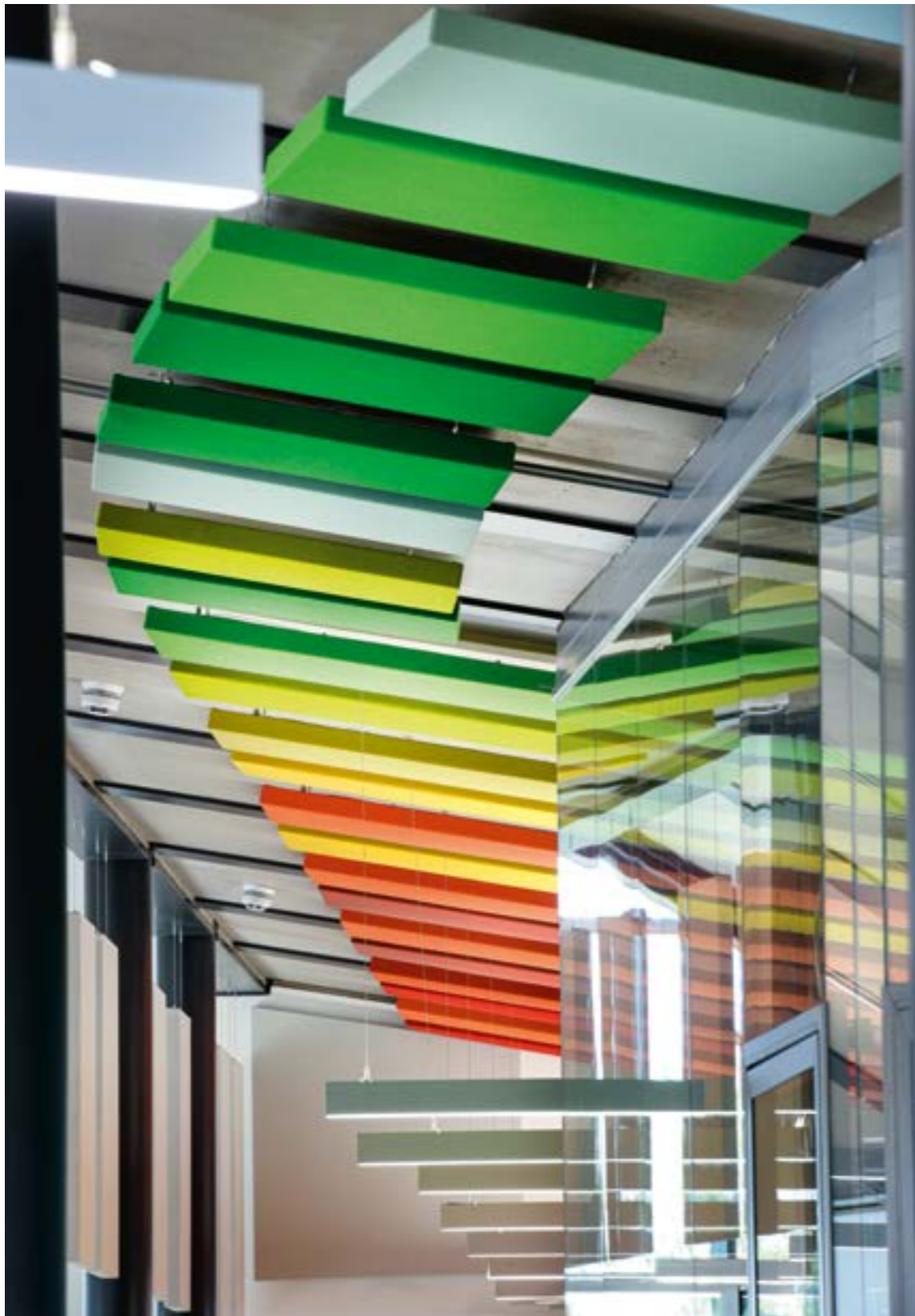
Deckenabgehängte Akustikpaneele Stereo über dem Bürobereich der Royal Horticultural Society in Wisley (Grossbritannien). Architekturbüro WilkinsonEyre, Geoff Turner, Associate Director, 2021.
